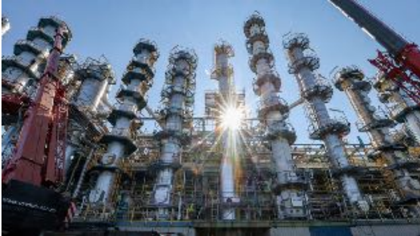
Kolonnen zur Phenolherstellung bei der Domo Chemicals GmbH in Leuna. (Foto: dpa)
